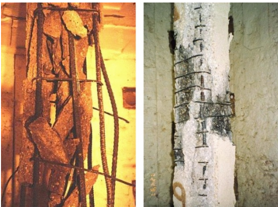
Bild 3 Reduktion des Abplatzens durch Verringern des Bügelabstandes und geeignete Verankerung der Bügel [13]
